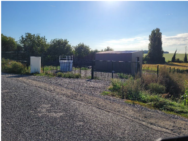
Forage et unité de traitement de l'eau
